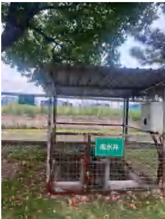
雨水排放口闸阀 2
