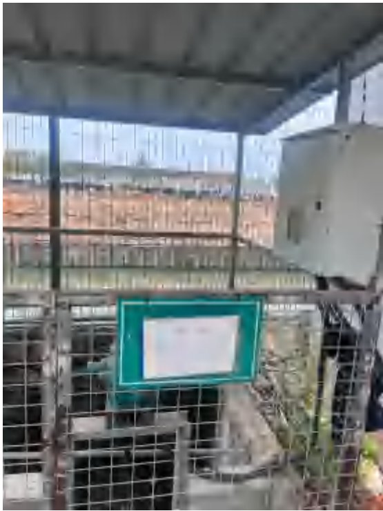
雨水排放口闸阀 1
