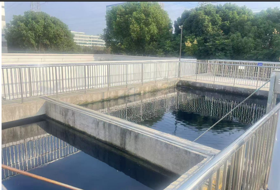
图3-5 C厂房新增生化处理设施
