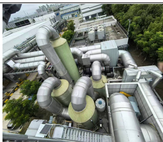
C 厂：二级水喷淋+一级化学喷淋+除雾+过滤器+沸石转轮+RCO 装置
