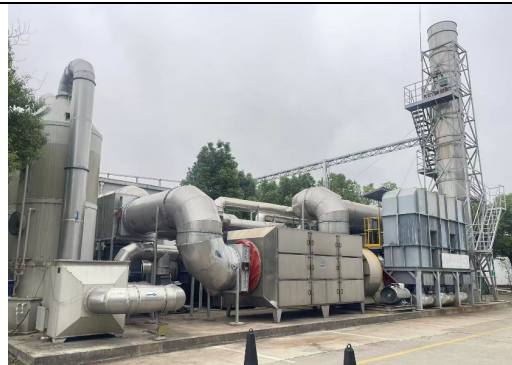
A 厂：碱喷淋+水喷淋+除雾+干式过滤+沸石转轮+RCO
